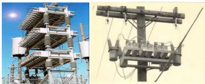
Снимка 5 Високоволтови кондензаторни батерии и измерителни трансформатори
