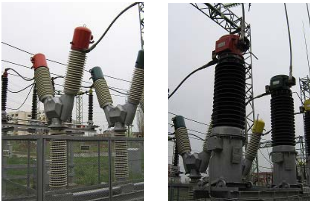
Снимка 7 Силови прекъсвачи и измерителни трансформатори
