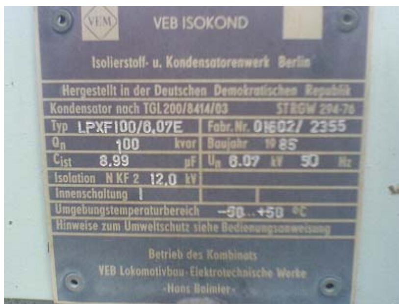
Снимка 6 Фабрична табела на кондензатор съдържащ ПХБ, Градска подстанция
