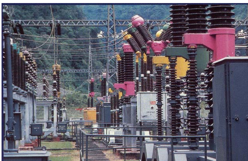
Снимка 8 Оборудване на открита разпределителна уредба (ОРУ) на подстанция
