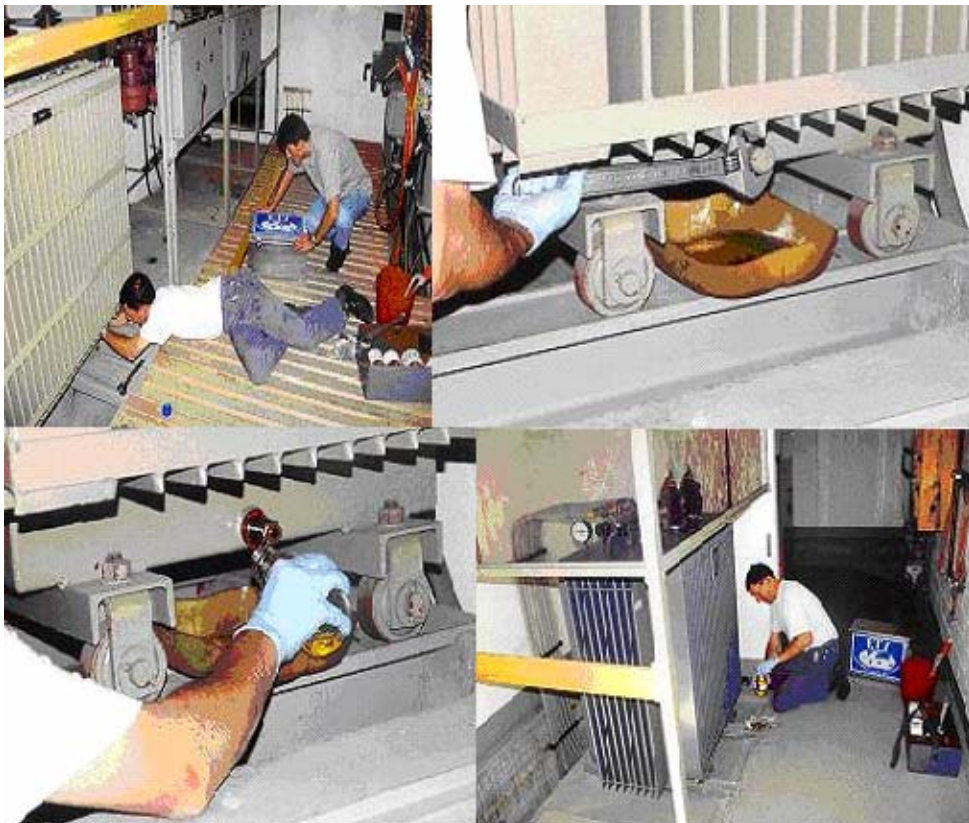
Снимка 9 Пробовземане от трансформатор
